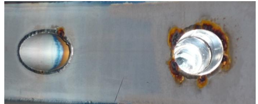
Corrosion de la chambre inox coté vide
